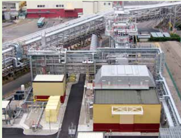
新潟工場内 ガスタービン発電設備
