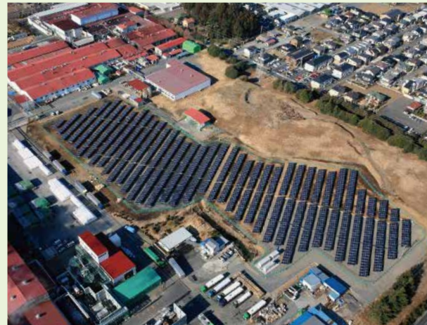
関東工場(勝田) 太陽光発電設備
