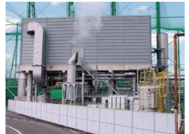
大阪工場 ガスコージェネレーション発電設備
