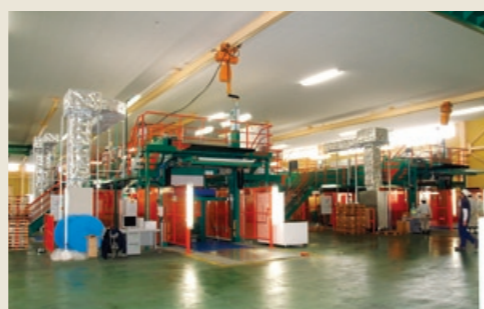
カッター設備
