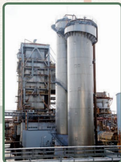
パルプ製造設備
