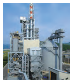
紀州工場 木質バイオマスボイラー
