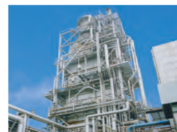
関東工場(市川) ガス排熱ボイラー
