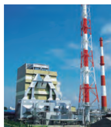
新潟工場 黒液回収ボイラー
