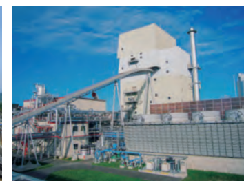
Kanto Mill (Katsuta) Wood biomass boiler
