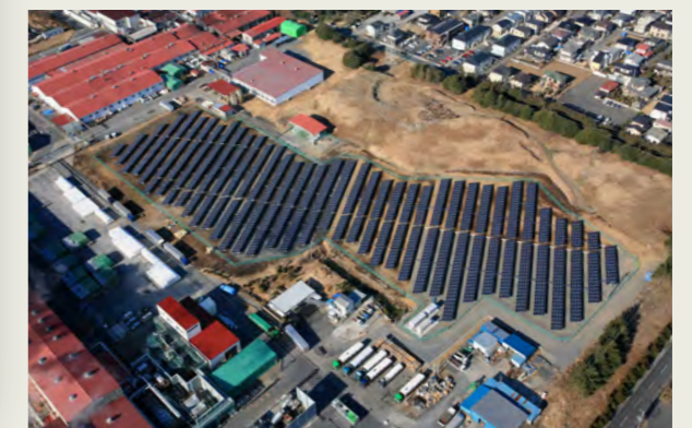
関東工場(勝田)の太陽光発電設備
