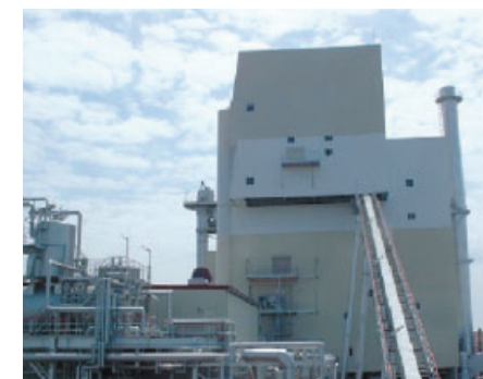
勝田工務部 バイオマスボイラー Biomass boiler at Katsuta Factory
