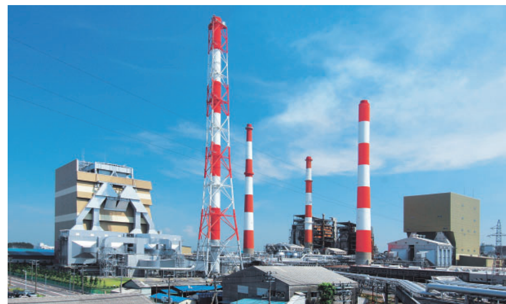
新潟工場 バイオマスボイラー Biomass boiler at Niigata Mill
