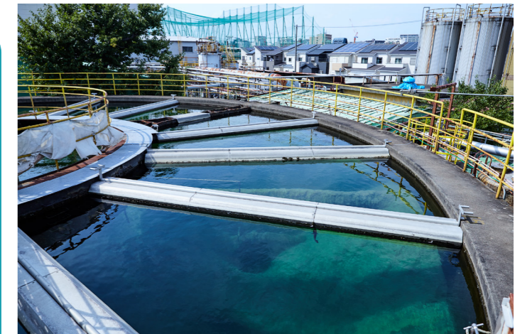
クリアレーター(凝集沈殿除濁装置)
