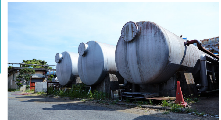
シリコン急速濾過器(圧力式急速濾過器)
