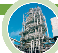
関東工場(市川)の天然ガス発電
