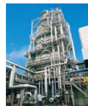
関東工場(市川) ガス発電
