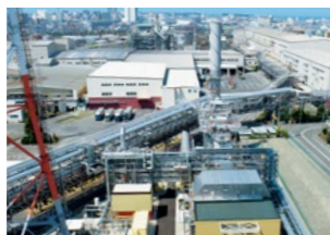
新潟工場ガス コージェネレーション システム
