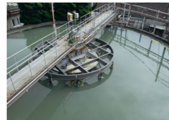
排水最終処理槽
