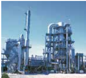
ペーパースラッジ焼却炉
