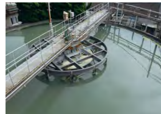
排水最終処理槽
